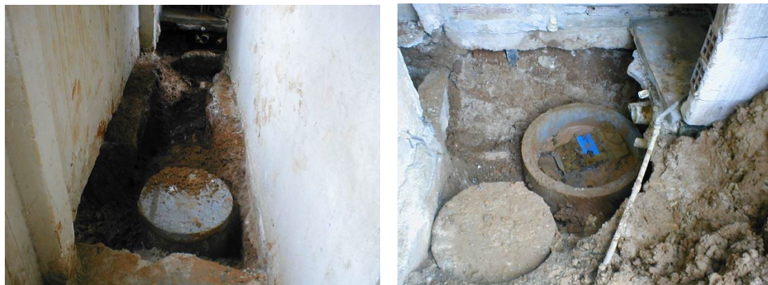
Figura 12: Situação típica de construção do ramal na tipologia “passa onde pode”, em que os ramais são construídos praticamente onde é possível. Fonte: EMBASA.
