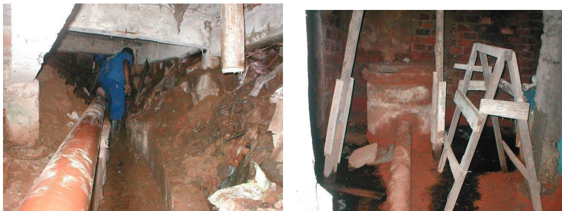
Figura 17: Imóveis construídos sobre a rede do sistema condominial, dificultando a sua operação e manutenção. Fonte: EMBASA.
